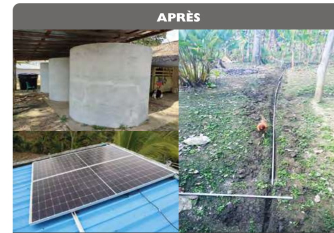
L'école de Carlos Ospina a été totalement équipée : réservoirs de stockage d'eau d'une capacité de 30000 m 3 , panneaux solaires avec une pompe servant à l'acheminement de l'eau et nouvelles gouttières pour récupérer les eaux de pluie. Nous avons également construit un système d'adduction d'eau et renouvelé entièrement le réseau de distribution d'eau. Désormais l'école est en capacité de collecter l'eau mais aussi de la stocker pour pallier les périodes de sécheresse.
